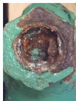
Рис.1. Отложение на вентиле
